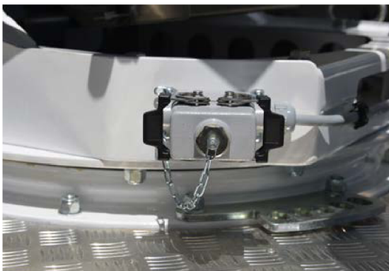
impianto elettrico protetto e di facile accesso
